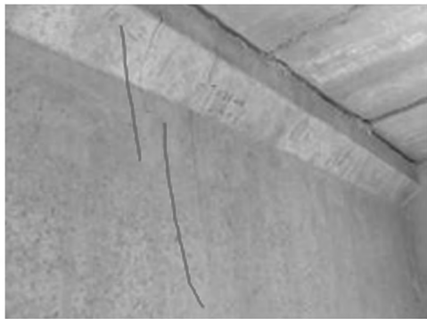
(b) 主梁竖向裂缝
